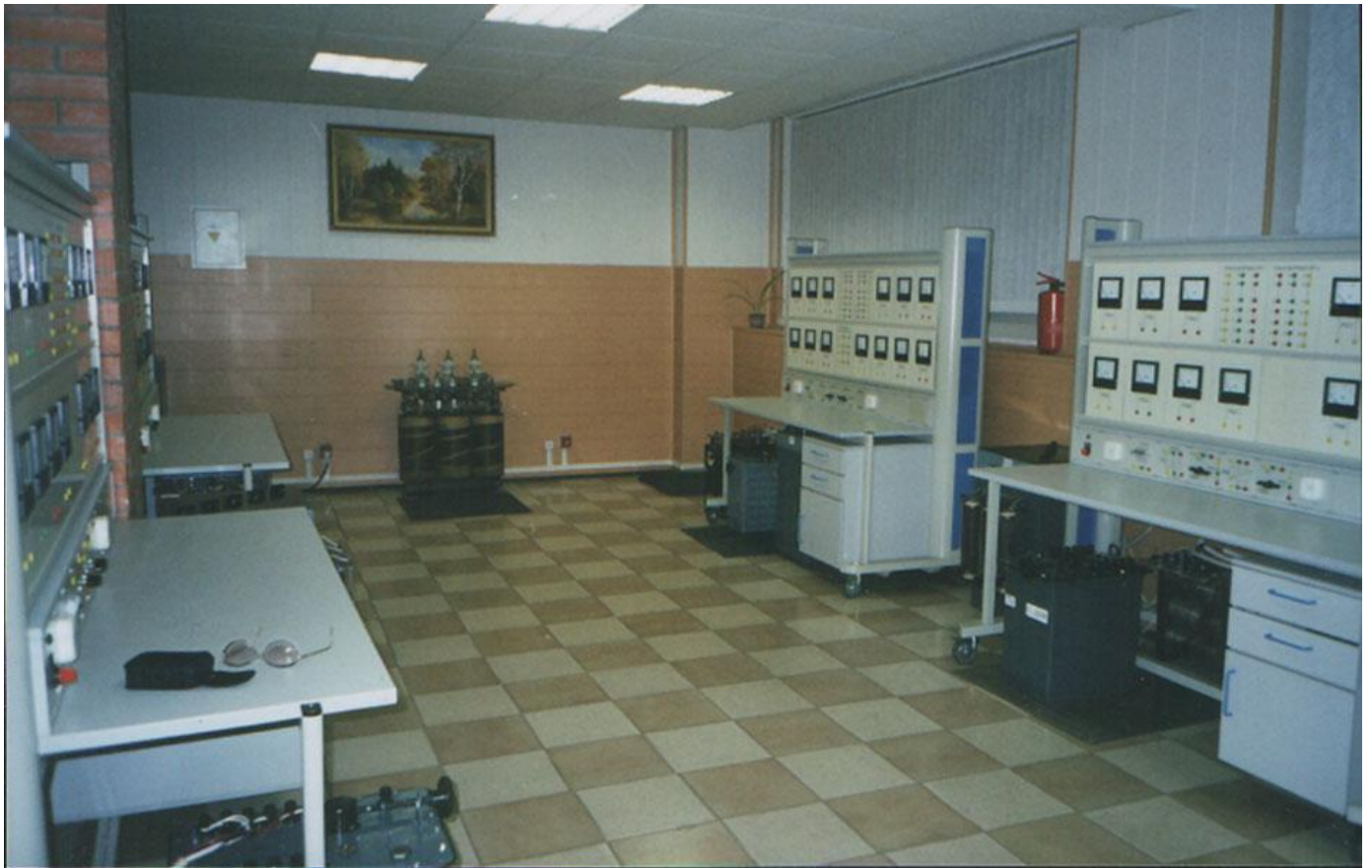
Рис. В.1. Общий вид лаборатории трансформаторов
